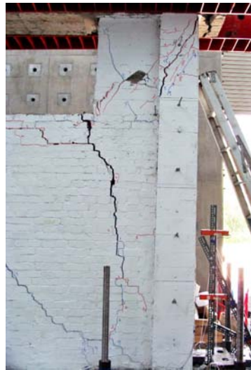
側位移比1.25%，新增之RC翼牆與短柱剪力裂縫延伸切過
