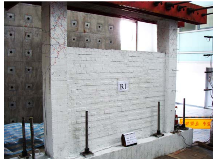
構架短柱區域剪力裂縫快速發展 (0.75%)
