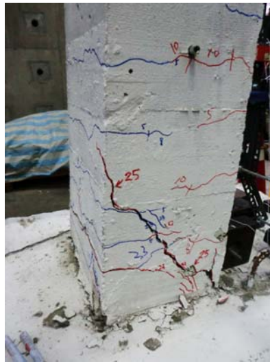
柱底處生45度剪力斜裂縫 (4.5%)
