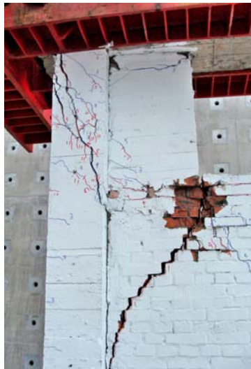
側位移比1.75%，紅磚受壓擠碎崩落
